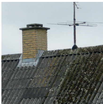
Ældre eternittage indeholder som oftest asbest.
