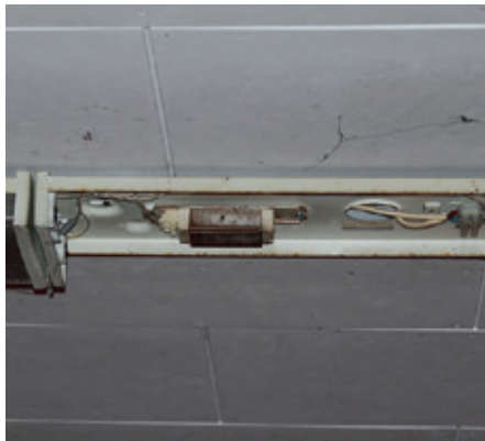
Ældre armaturer til lysstofrør indeholder ofte PCB.
